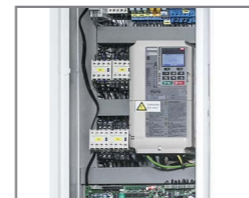
Quadro di manovra Impianto Mrl
