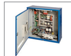
Quadro di manovra Impianto oleodinamico
